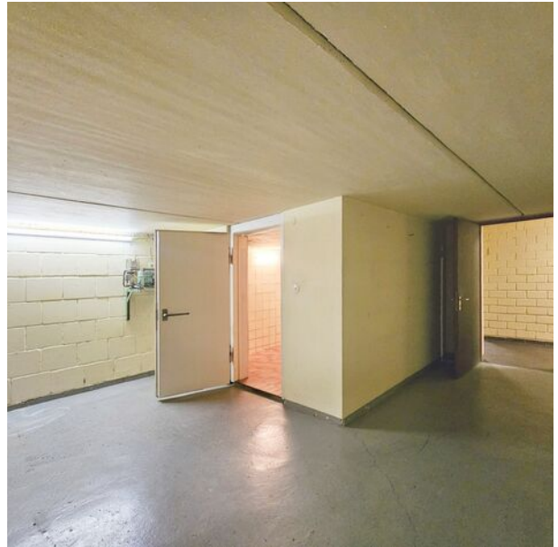
Kellerraum mit Kühlraum
